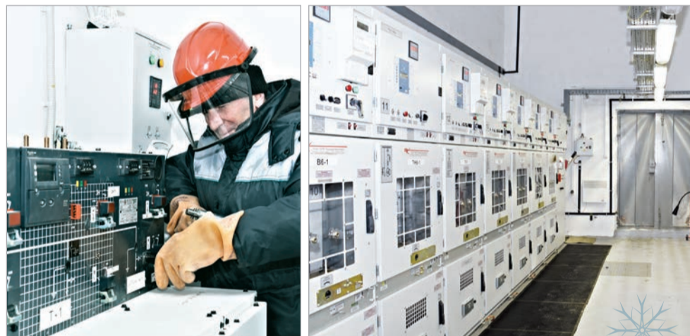
Дежурный электромонтер Владимир Николаевич Грулев запускает в эксплуатацию ТП-19; новое оборудование на РПП-10
